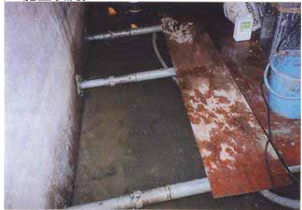
止水が完全でないため作業台を設置
